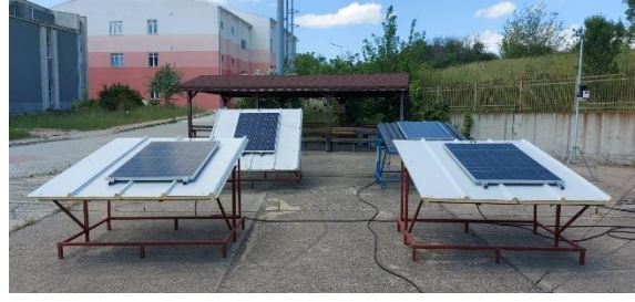
Şekil 4. PV sistem fotoğrafı
