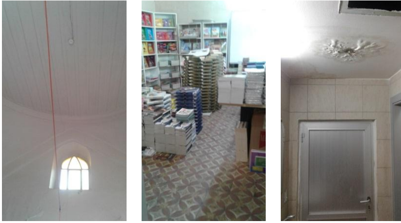
Şekil 41-42-43: Mehmet Ağa medresesinde gözlemlenen koruma problemleri (2017)
