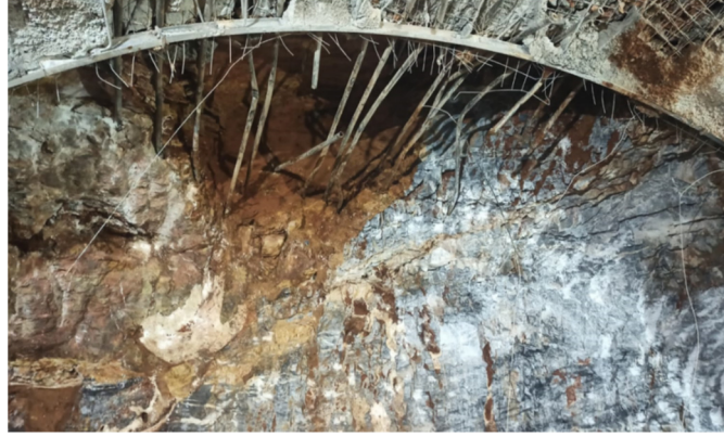
Şekil 7. Tünel sol tüp tavan kesimindeki karstik boşluktan bir görünüm
