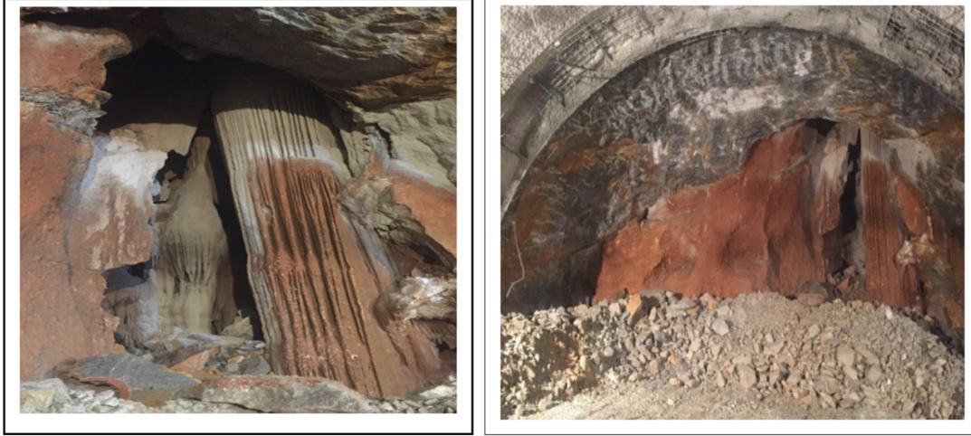
Şekil 6. T3 Tüneli sol tüpte (km:148+122,08- 148+129,08 arası) geçilen karstik boşluklar
