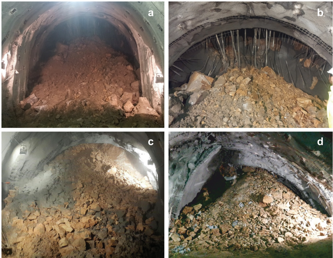
Şekil 8. Tünellerde gelişen aşırı sökülme sonrası ayna görüntüleri a) Yaklaşım tüneli km:0+286, b) Yaklaşım tüneli km:0+291, c) Yaklaşım tüneli km:0+308, d) T2 tüneli km:0+935.
