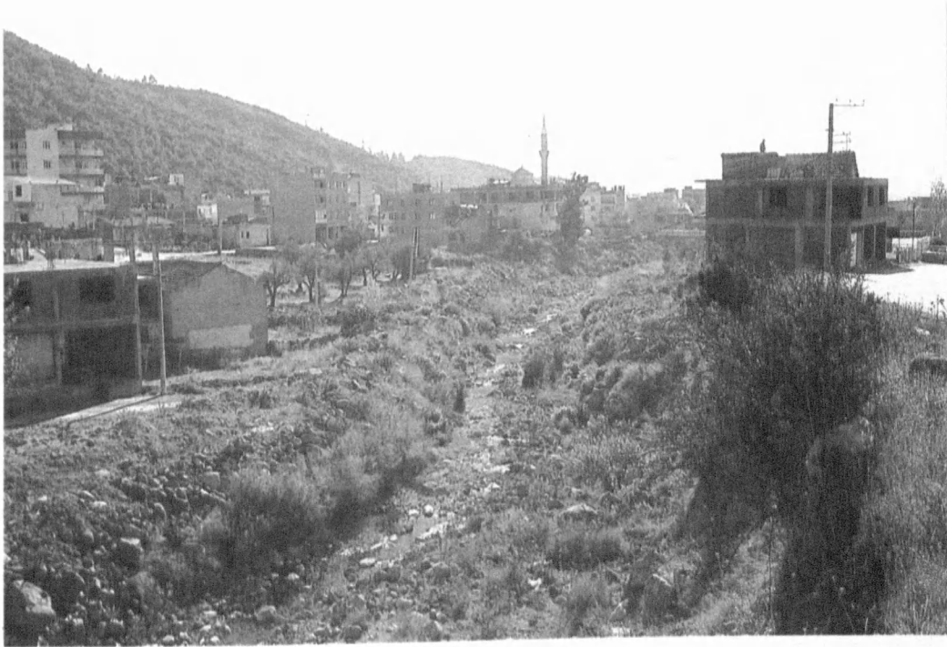
Foto: 12- Kasım 1999. Örnekköy deresi. Sel olayından sonra, Örnekköy deresi yatağında temizlik ve genişletme çalışmaları yapılmış olmakla beraber, yatak kenarı yapılarla dolu olduğundan yatak kısmen derinleştirilmiştir. Yatak içinde yer yer daralmalar söz konusudur. Her yıl temizlik yapılmadığından yatak içi yabani bitkilerle kaplanmıştır.
