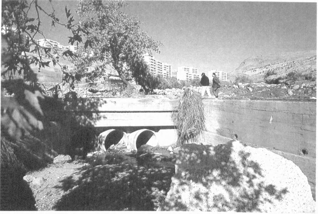
Foto: 1- Kasım 1995. Değirmendere üzerinde yer alan Sadık Ahmet Köprüsü. Köprü altında akışı sağlamak amacıyla yapılan 1 m. Çapındaki 3 büz, sel sırasında tıkanmış ve sular bu noktadan itibaren yerleşim alanlarının bulunduğu geniş bir sahayı etkilemiştir.
