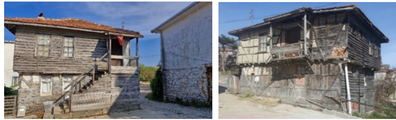
Şekil 26. Akçakese Köyü'nde alt ve üst katı iki bağımsız konuta ayrıldığı için muhdes merdiven eki alan geleneksel yapı, Emsal Sokak, No:1 (28 Ağustos 2024'te yazar tarafından fotoğraflanmıştır). Yapının arka cephesinde oluşan malzeme kayıpları, yapının strüktürünün ve malzemelerinin okunmasını mümkün kılmakta (Arkan, 2020, 163).
