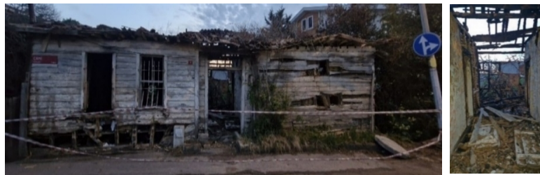
Şekil 46. Terk edilmiş ve ciddi hasar görmüş 1 katlı asimetrik geleneksel yapı ve iç hacimleri, Cami Sokak, No:2 (3 Nisan 2025'te yazar tarafından fotoğraflanmıştır).
