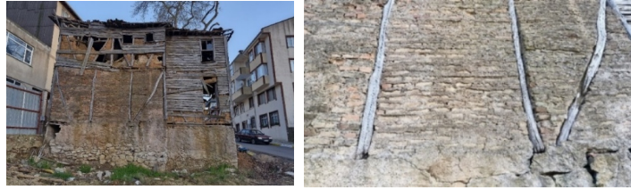
Şekil 44. Yukarıdaki yapının kuzey cephesinde malzeme kayıpları, yapının strüktürünü okumayı mümkün kılmakta, Zeki Müren Caddesi, No: 14 (3 Nisan 2025'te yazar tarafından fotoğraflanmıştır).
