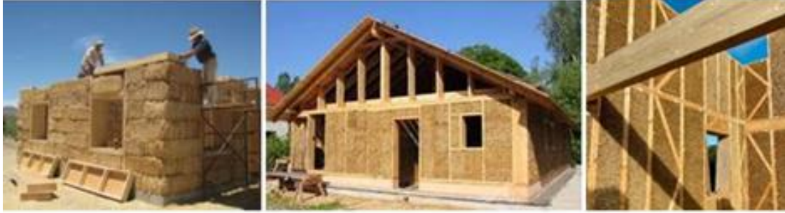
Şekil 5. Yığma, karkas ve panel saman yapım teknikleri, 5a: URL-7, 5b: URL-8, 5c: URL-9.
