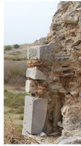
Fot.37-38: Yıkık olan batı taçkapısının içten görünümü ile kuzey yöndeki sövesinin detayı
