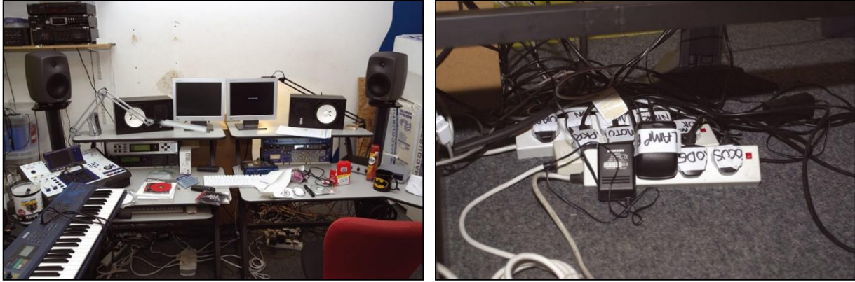
Şekil 20: Amatör kayıt stüdyosunda çalışma istasyonu altındaki kablo dağınıklığı ve priz çoğaltıcı kullanım örnekleri, Manchester-İngiltere (URL-18)
