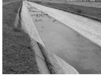
Şekil 18. Urfa ana sulama kanalı içerisinde taşlar
