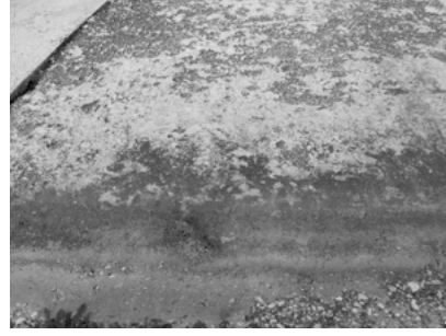
Şekil 9. Urfa ana kanalı; yanmış bir şev beton kaplaması
