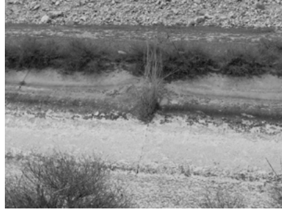
Şekil 8. Urfa ana kanalı şevi, derz aralığında oluşan bitkiler
