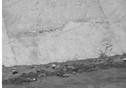
Şekil 6. Urfa ana kanalında ( UY4) çatlamış ve kısmen oturmuş beton kanalı
