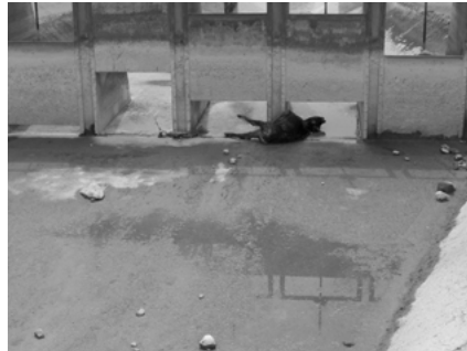
Şekil 21. Urfa ana kanalındaki bir su yapısının kapağına sıkışmış bir hayvan
