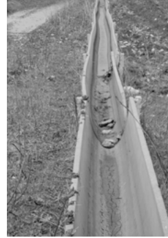
Şekil 15. Kanalet şebekelerinde oturmalara bağlı olarak bozulmalar
