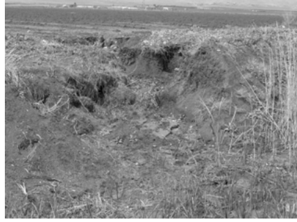
Şekil 23. Urfa drenaj kanalı şev akmaları ve bitki oluşumu
