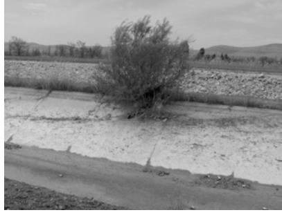
Şekil 7. Urfa ana kanalı beton kaplamasında oluşan bitkiler
