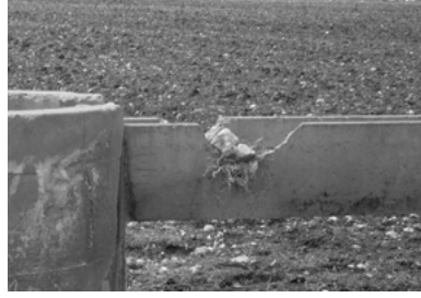
Şekil 13. Urfa sulamalarında kanaletlerin kırılarak su alınması
