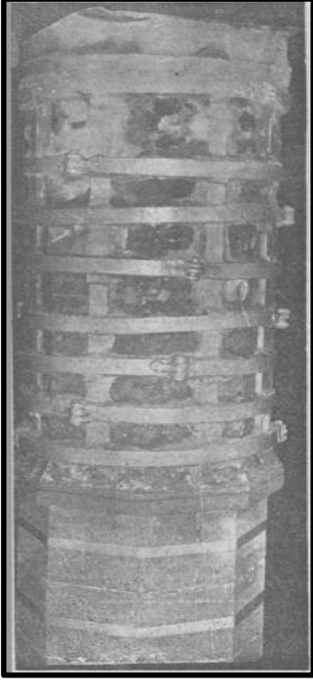
Resim 8: Ulu Camii'nin çatlayan bir sütunu tamir sırasında böyle çemberlenmiştir.
