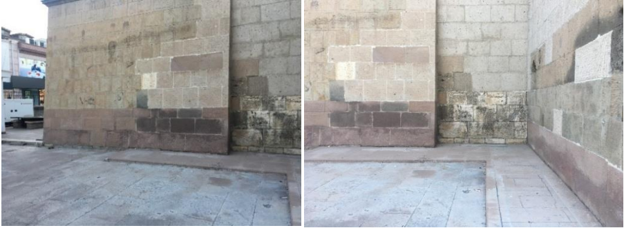
Foto 6: Medresenin dış duvarlarında nem kaynaklı renk değişimi
