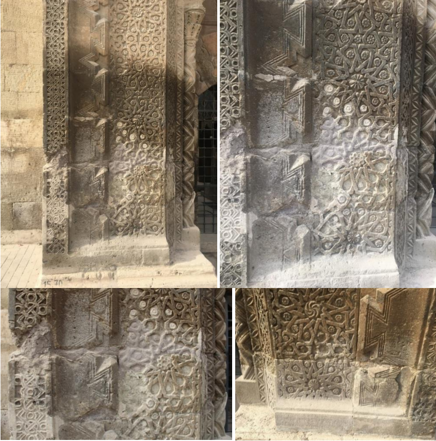
Foto 3: Taş kapıda giriş kısmında gözlenen nem kaynaklı renk değişimi, çiçeklenme ve yüzeylerde kopmalar, taş işlemlerinde kayıplar
