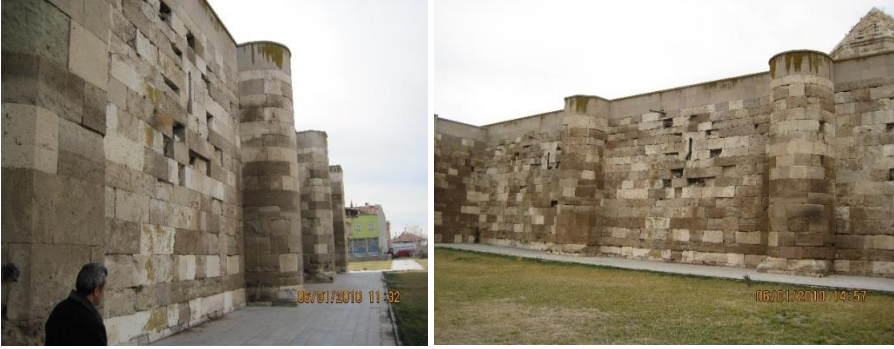
Foto 10: Oluklardan gelen yağmur suyu etkisiyle oluşan bozulma
