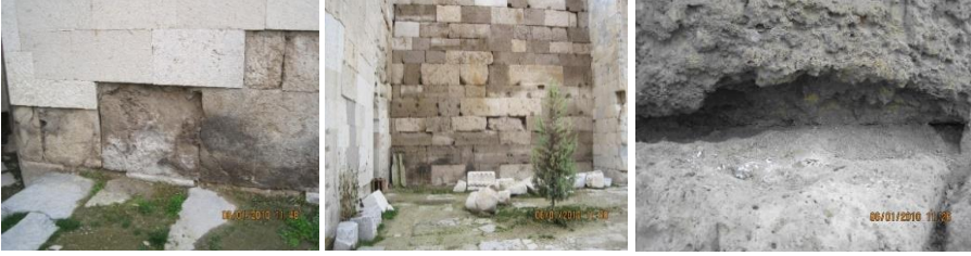
Foto 9: Suyun kapiler olarak yükselmesi sonucu kervansaray duvarlarda oluşan bozulmalar
