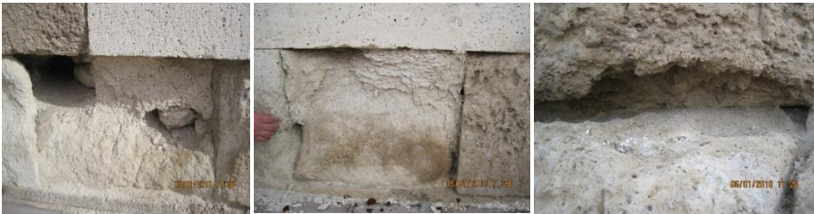
Foto 8: Sultanhanı Kervansarayı duvarlarda yapı taşı olarak kullanılan Andezitik Tüfteki ve marn'da bozulmalar
