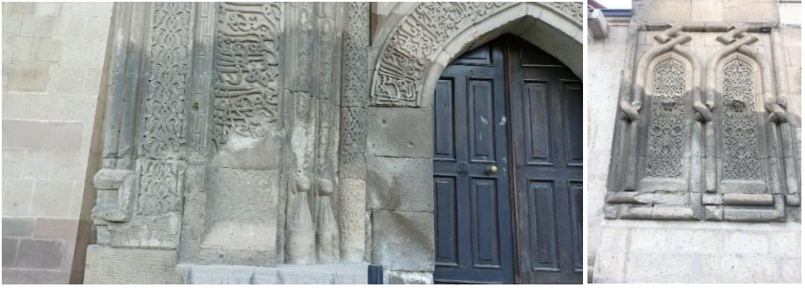
Foto 5: Taç kapıda giriş kısmında ve minare kaidesinde gözlenen nem kaynaklı renk değişimi, çiçeklenme ve yüzeylerde kopmalar, taş işlemlerinde kayıplar
