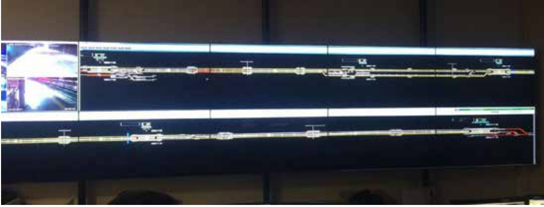
Şekil 2.1. Marmaray kumanda izleme paneli
