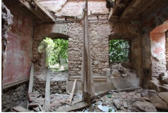
Fotoğraf 11: Zemin katta yıkık oda
