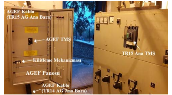
Şekil 22. TR15’e monte edilen AGEF panosu ve bağlantıları (AGEF panel and connections installed at TR15)
