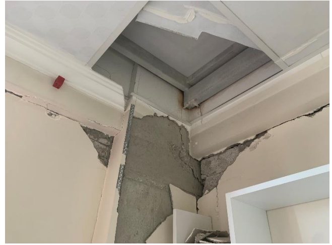
Şekil 1. Deprem sonrası Malatya’da incelenen ilgili binadan saha fotoğrafları.
