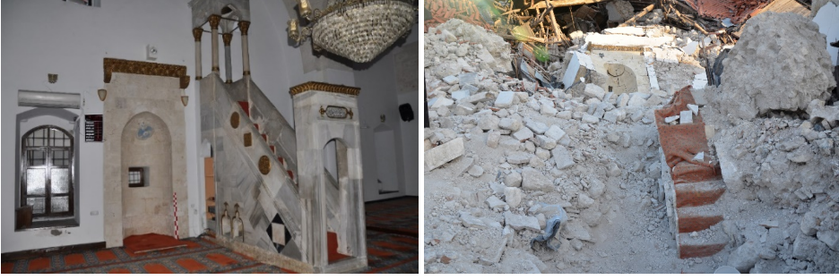
Resim 6: Antakya Yeni Camii Minberi ve 06.02.2023 Kahramanmaraş Merkezli Deprem Sonrası Genel Görünümü (Kaya, 2023)
