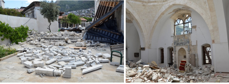
Resim 10, 11: Antakya Şeyh Ali Camii ve minberinin, Deprem Sonrası Genel Görünümü (Kaya, 2023)
