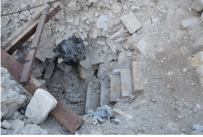
Resim 8: İhsaniye Camii Minberinin 06.02.2023 Kahramanmaraş Merkezli Deprem Sonrası Genel Görünümü (Kaya, 2023)
