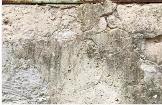
Şekil 7. Yüzey Kalitesi Düşük Bir Betonarme Duvar Örneği
