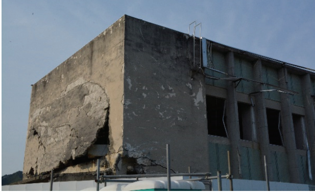
Fotoğraf 13. Hasar Almış Betonarme Yapı, Otsuchi (Tarih: Haziran, 2016)
