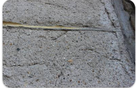
Resim 27. İç yapısı bozulmuş ve çatlaklar oluşmuş taş. (hastalanmış taş) Figure 27. The stone with deteriorated inner structure and has cracks
