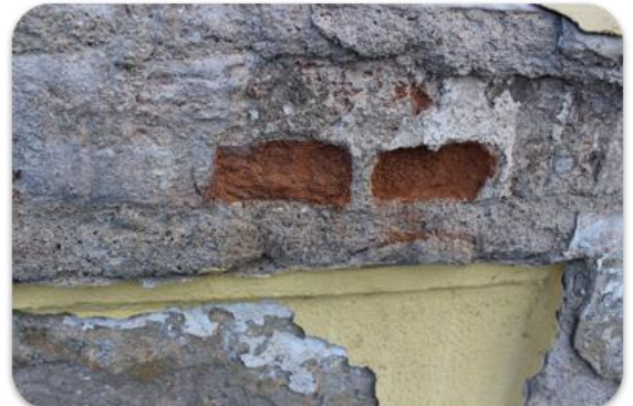
Resim 29. Hem tuğla hem de üzerinde bulunan kaplamalar tamamen hasara uğramıştır. Figure 29. Both the brick and its covering are completely deteriorated
