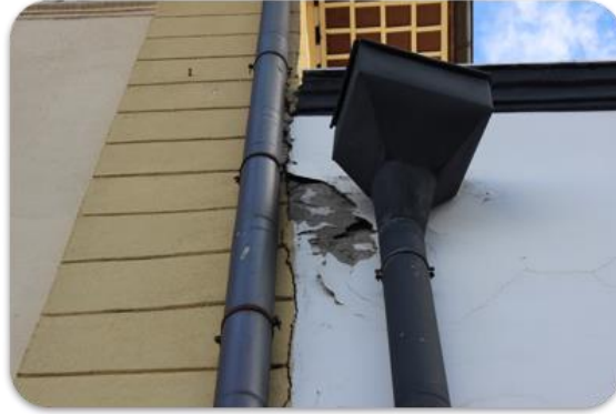
Resim 11. Bitişik yapılarda dilatasyon derzi düzenlenmemesi ile oluşan çatlaklar ve komşu binada saçak detayı sorunları.
