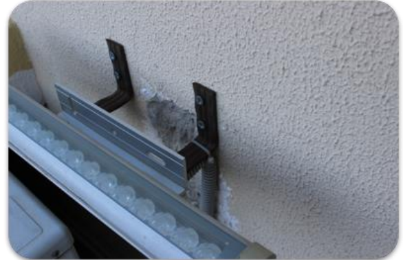
Resim 19. Yapıya sonradan eklenen dış aydınlatma elemanlarının montajı sırasında oluşan hasarlar.
