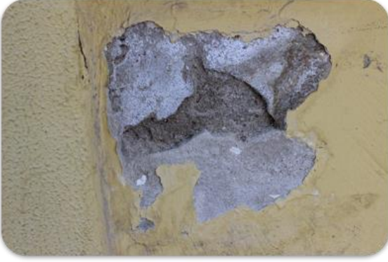
Resim 14. Su etkisine maruz kalmış hasarlı yüzeylerde çiçeklenme.
