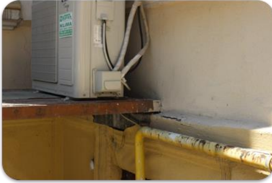
Resim 18. Yapı cephelerine montajı yapılan klima soğutucu elemanları.
