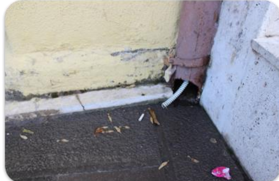
Resim 10. Yağmur indirme borusundan gelen sular yanlış detay sebebiyle zeminden uzaklaştırılmıyor.
