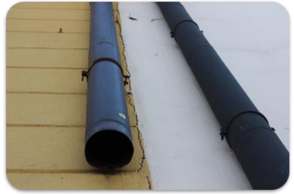
Resim 13. Dilatasyon derzi yapılmamış kısımlarda oluşan çatlaklar.
