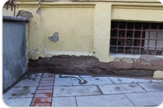
Resim 8. Resim 7'de görülen hasar bölgesinin yağışlı bir günde görüntülenmesi.
