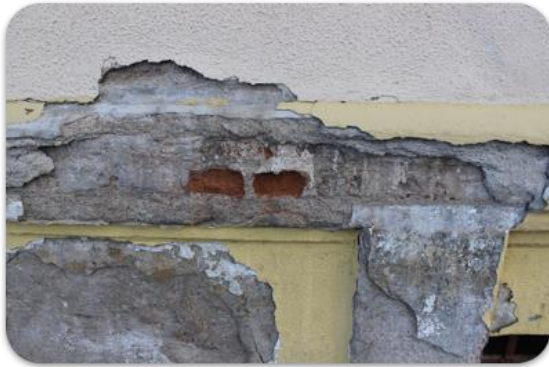
Resim 28. Özelliğini kaybetmeye başlamış tuğla. Figure 28. Brick which started to lose its characteristics
