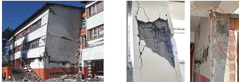
Şekil 8: İncelenen binalarda karşılaşılan hasar ve tespitlere dair fotoğraflar Figure 8: Photographs of the damage and findings encountered in the inspected buildings
