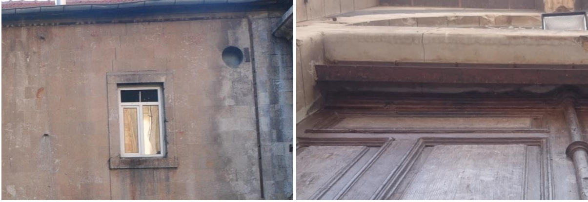
Şekil 15. Okul cephesi don etkisiyle ortaya çıkan derz ayrılımları, kilise lentosu
