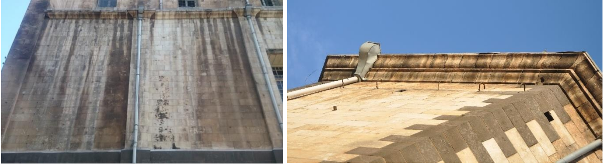
Şekil 13. Kilise cephelerinde patina erozyonuna uğrayan yüzeylerde kararma
