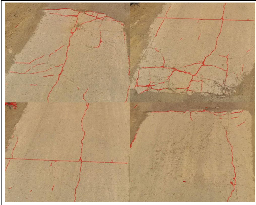
Şekil 4. Çeşitli yüzey dokularında gerçekleştirilen çatlak tespit sonuçlarının genel görünümü.
