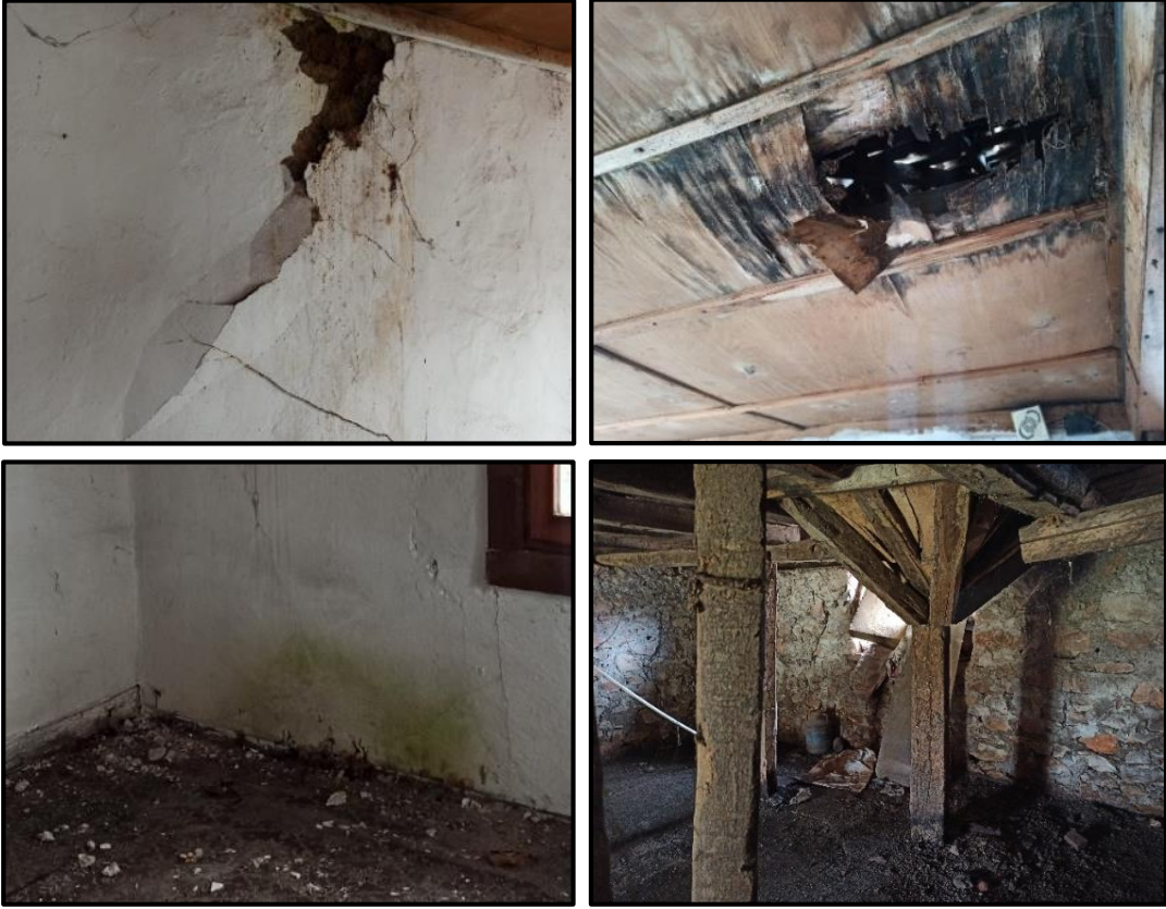
Şekil 14. Yapılarda görülen bozulmalar [11]
