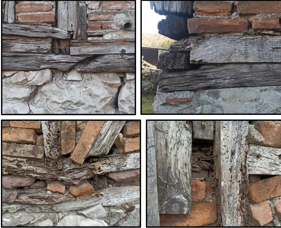
Şekil 15. Birleşim noktalarındaki malzeme bozulmaları [11]
