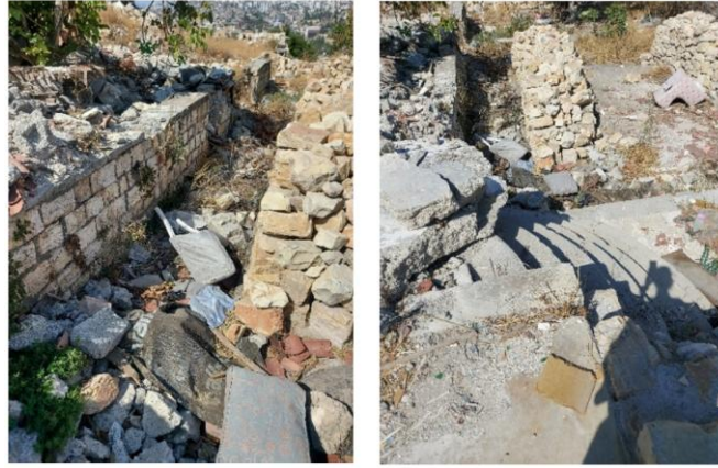
Şekil 10. Hasan Arıkan Evi Avlusundaki Çeşme ve Merdivenin 6 Şubat 2023 Depremleri Sonrasındaki Durumu (Fotoğraflar Yazar Tarafından Çekilmiştir)
