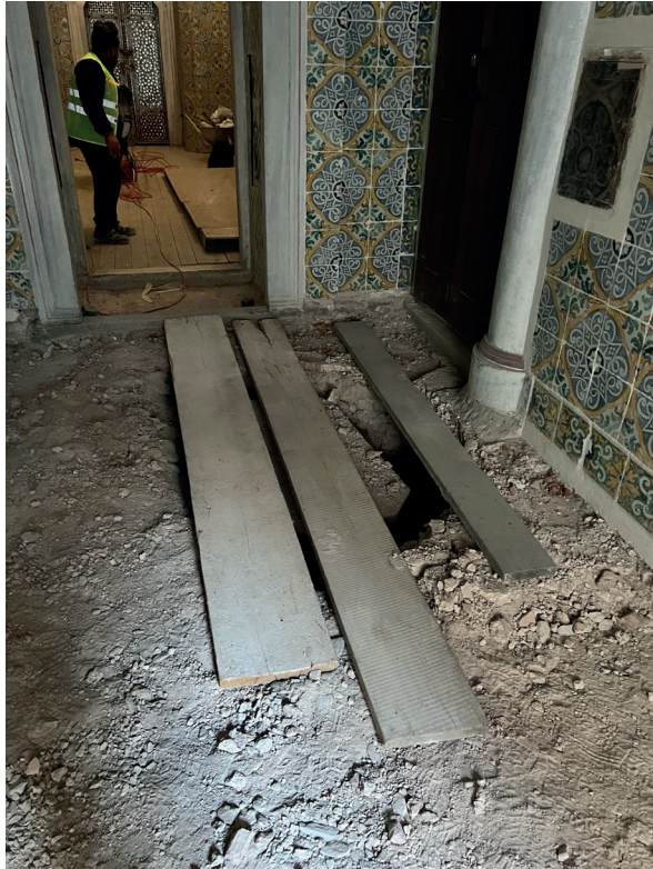
Şekil 20: Vâlîde Giriş Holü Zemindeki Göçmeler (2025), Milli Saraylar Fotoğraf Arşivi
