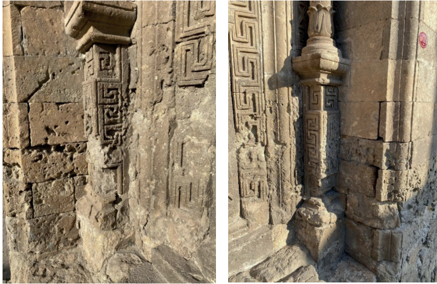
Şekil 12: Taş Kapıda Görülen Yüzeysel Kayıplar (Dırık, 2025)
