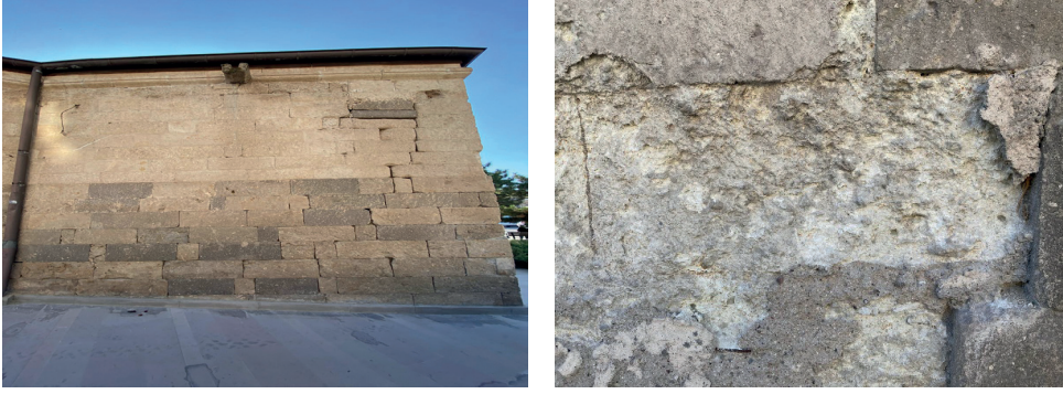
Şekil 14: Doğu cephesinde bağlayıcılarda dökülme, pul pul dökülme, ufalanma ve aşınma bozulmaları (Dırık, 2025)
