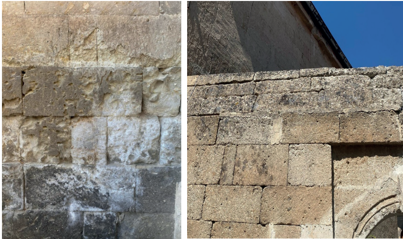
Şekil 17: Güney Cephe Taşlarında Nemlenme Nedeni ile Meydana Gelen Çiçeklenme ve Liken Oluşumları (Dırık, 2025)
