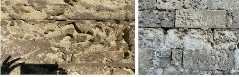
Şekil 11: Batı Cephesi Taşlarında Görülen Süreksizlikler ve Yersel Aşınmalar (Dırık, 2025)
