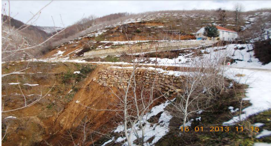
Şekil 16. 1 nolu heyelanın yakın görüntüsü
