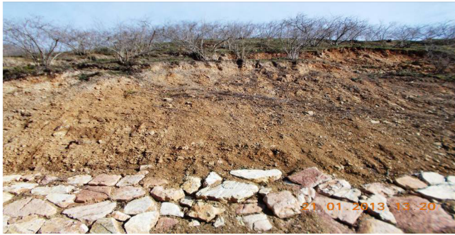
Şekil 18. 2 nolu heyelanın taş kısmında yaklaşık 50-1 metrelik oturumların görüntüsü
