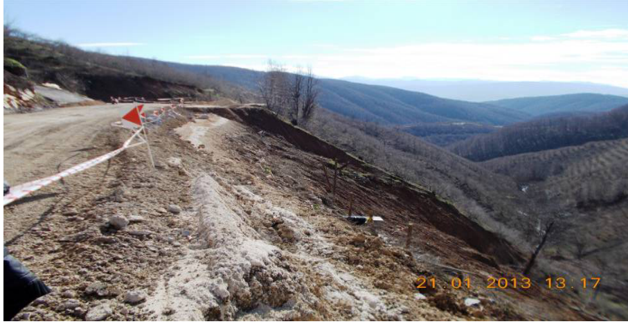
Şekil 17. 2 nolu heyelanın yakın görüntüsü
