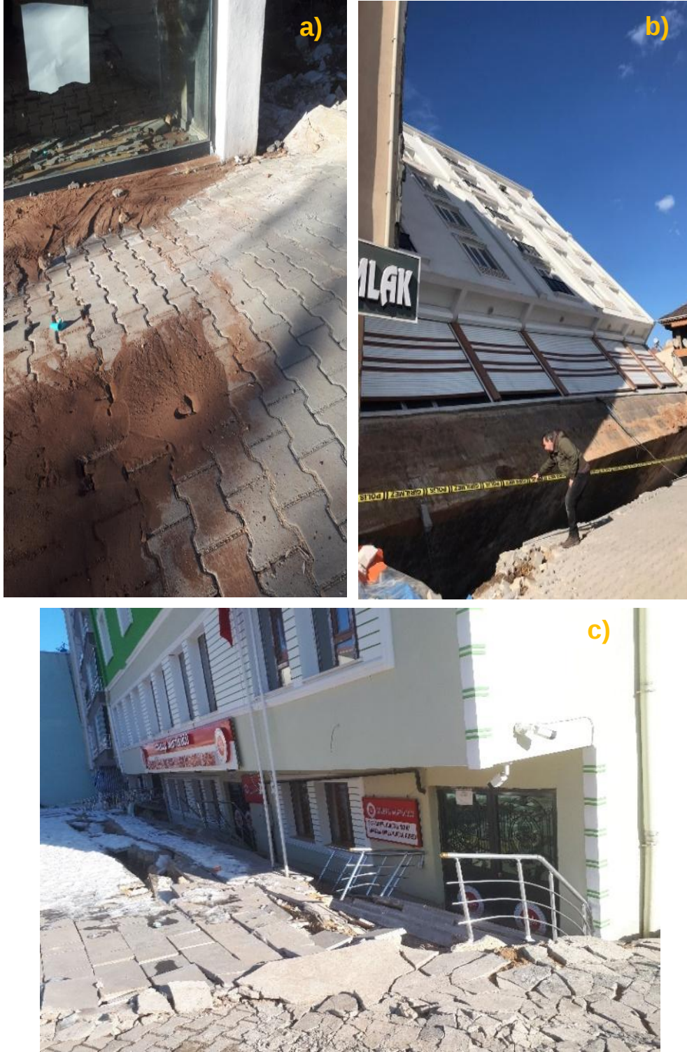
Şekil 13: Gölbaşı ilçesinde; a) Sıvılaşma nedeniyle oluşan kum kaynamaları ( 37^{\circ}.47'.23.29''K / 37^{\circ}.38'.27.30''D ), b) Çevrimsel yumuşama sonucunda taşıma gücü kaybı sebebiyle yapıda (Kayı Apt.) oluşan devrilme ( 37^{\circ}.47'.17.57''K - 37^{\circ}.38'.55''D ) c) Sıvılaşma nedeniyle yapıda meydana gelen oturma ( 37^{\circ}.47'.15.20''K - 37^{\circ}.38'.31.73''D )
