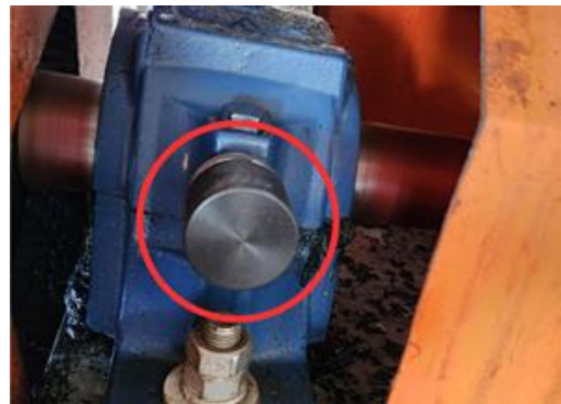
Şekil 1. Vakum fanında kasnak tarafı yataklamaya yerleştirilmiş 3 eksenli Able Sens ivme sensörü
