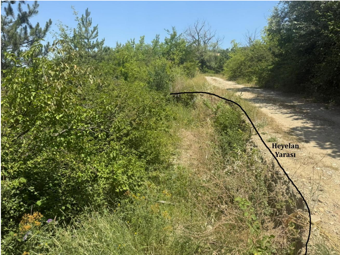
Şekil 12: Heyelan nedeniyle deformasyona uğramış olan Muratbey Kırsal Mahallesi eski yolu ve heyelan yarasının görüntüsü (28.06.2025) / Figure 12: View of the old road of Muratbey rural neighborhood deformed by the landslide and the resulting landslide scar (28.06.2025).
