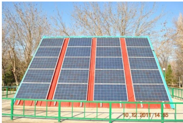
Рис. 7 Мониторинг эффективности работы солнечной панели, установленной в г. Ашгабат
