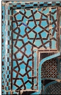
Görsel 23. Mihrap sol köşeliği, restorasyon öncesi (Afyon VM arşivi, 2019)
