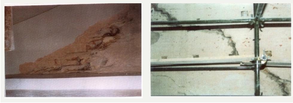
Görsel 13: Beden Duvarları Üzerinde Görülen Çatlaklar Kaynak: EVBM Arşivi, 1991
