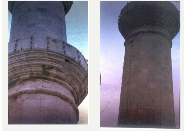
Görsel 12: Minare Şerefe Altı Taşlarında Kopma
