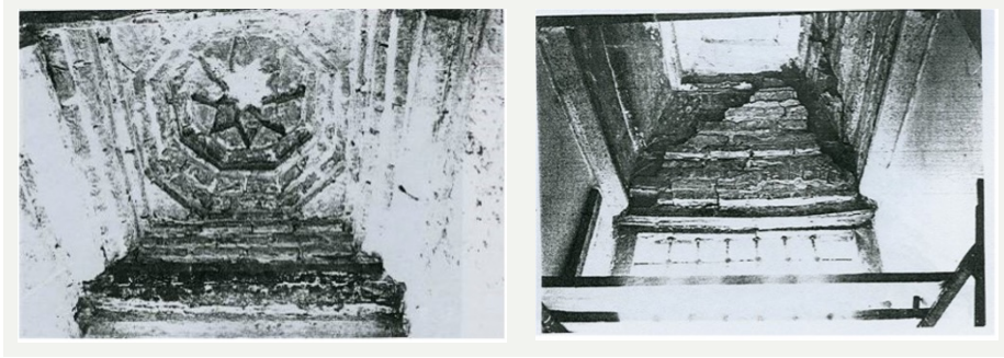
Görsel 11: Pencere Nişlerinin Üst Örtülerindeki Çatlaklar
