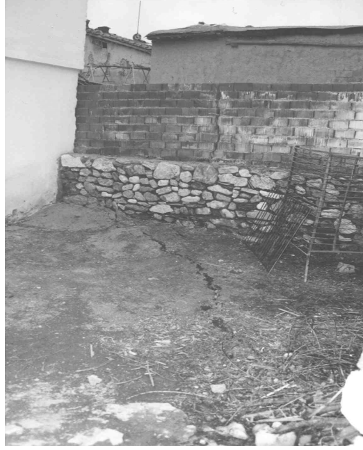
Şekil 2. Çay ilçesi Yaka mahallesindeki yüzeysel fay kırığı
