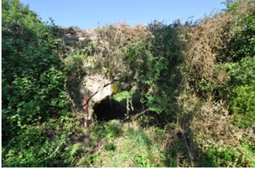
Resim 14: Toprak dolgu ile yükselen orijinal taban seviyesi nedeniyle yapının temelden başlayan tahribatı.
