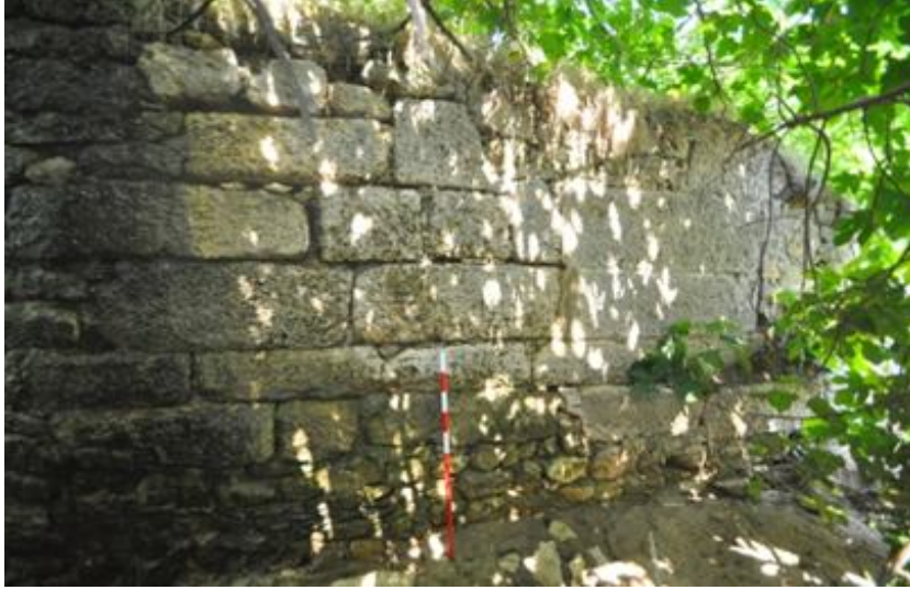
Resim 10: Ortakçı Kemer, İstinat Duvarı.
