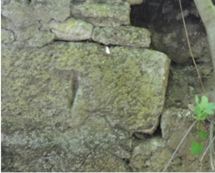
Resim 17: Yapıların genelinde gözlenen taş yüzeyde liken ve yosun oluşumları.
