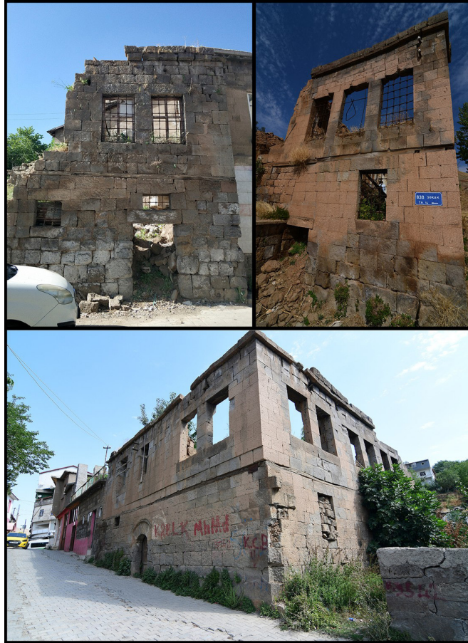
Şekil 5. Gerekli yapısal müdahalelerin zaman içerisinde yapılmaması sonucu hasar alan tarihi Bitlis evi örnekleri
