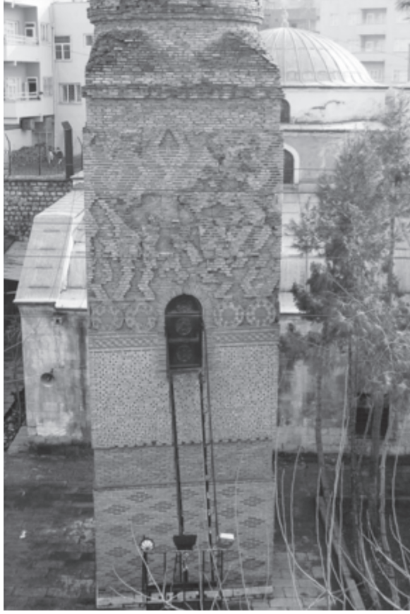
Resim 3 : Siirt Ulu Camii, onarım öncesinde minarenin kaide kısmı.
