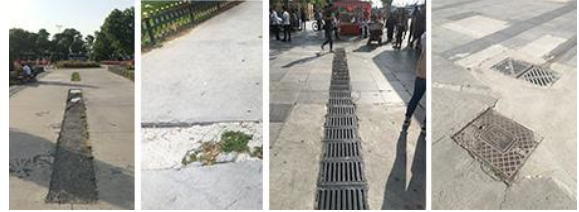
Şekil 31. Zemin Döşemesindeki Olumsuzluklar (Kutsal Göllü, 2018)
