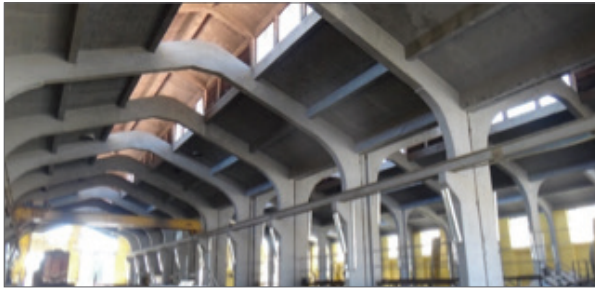
Şekil 49 Tren Bakım İstasyonu iç mekân, 2013
