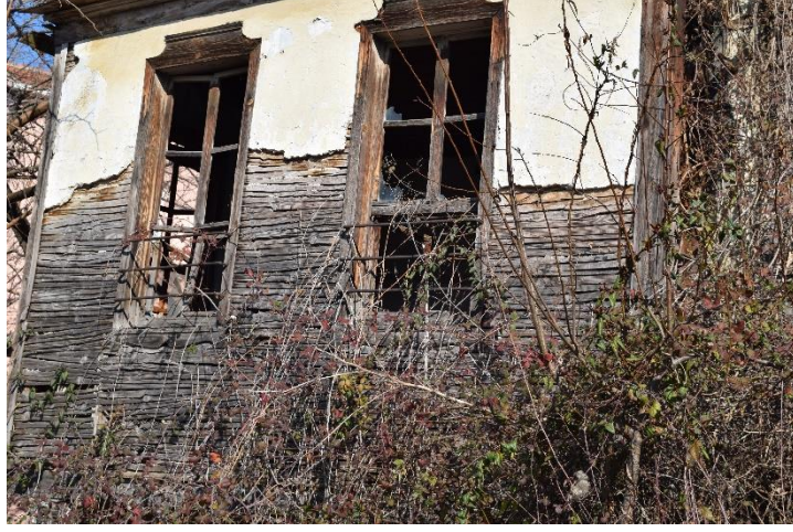
Fotoğraf 3: Alaçam'da bağdadi tekniğiyle inşa edilmiş ve sıvası dökülmüş konut örneği
