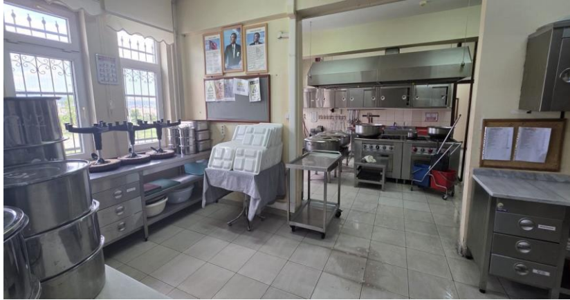
Resim 7. Uygulama mutfağında ocak, fırın, davlumbaz ve genel yerleşim
