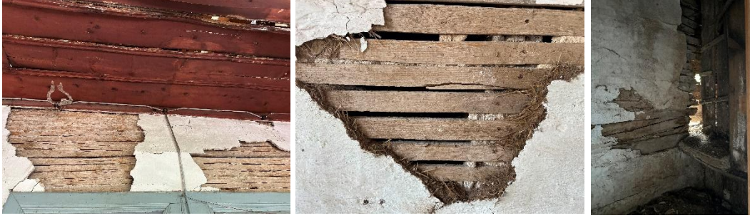
Görsel 9. Sıva dökülmeleri ile okunan bağdadi tekniği
