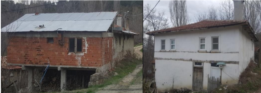
Şekil 18. Ek Yapı ve Özgün Olmayan Doğramalar
