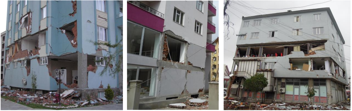
Şekil 1. Mw=7.2 Van depremi düzlem dışı dolgu duvar hasarları
