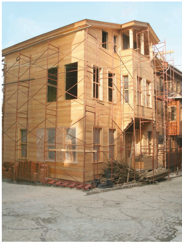
Süleymaniye, Kayserili Ahmetpaşa Sokağı, 569ada 13 parselde yer alan ahşap yapının eski hali ve uygulama sonrası fotoğrafları
