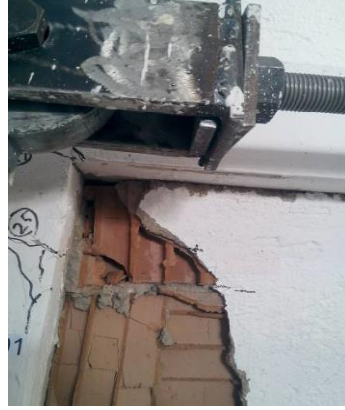
Dolgu duvarda meydana gelen hasar ve kolonlarda oluşan kesme çatlakları
