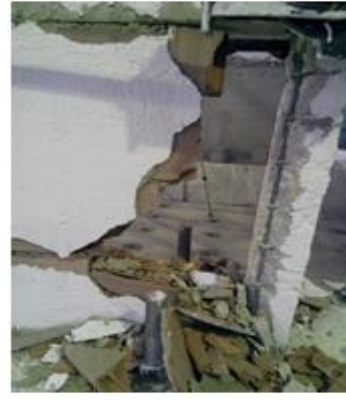
Kolonlarda kabuk betonun dökülmesi ve dolgu duvar hasarı
