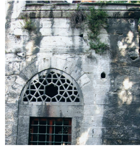
Duvar yüzündeki bozulma
