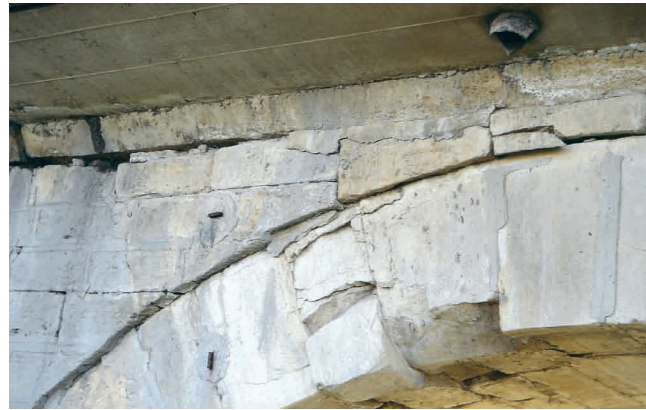
Resim 13: Edirne Uzunköprü ilçesi Uzunköprü kemerlerinden birinde oluşan deformasyon
