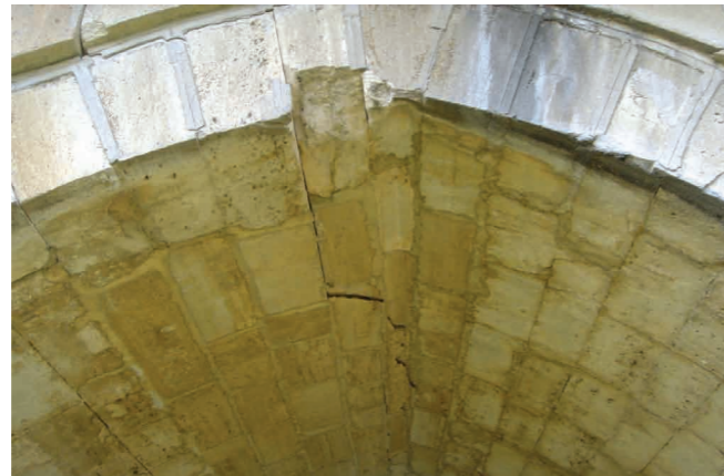
Resim 1: Edirne Uzunköprü ilçesi Uzunköprü kemerlerinden birinde deformasyon .
