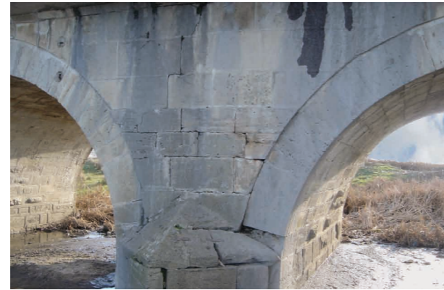
Resim 14: Edirne Uzunköprü ilçesi Uzunköprü ayaklarında deformasyon
