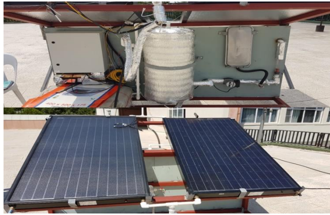
Şekil 3. Balıkesir Çağış kampüsünde kurulan PV/T sistemi.
